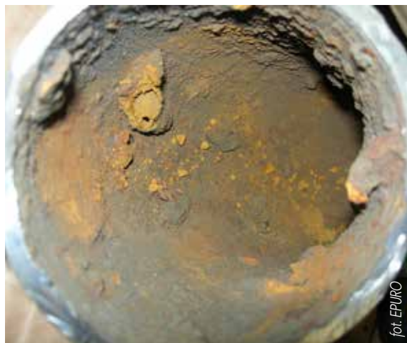
OSADY z produktów korozji
